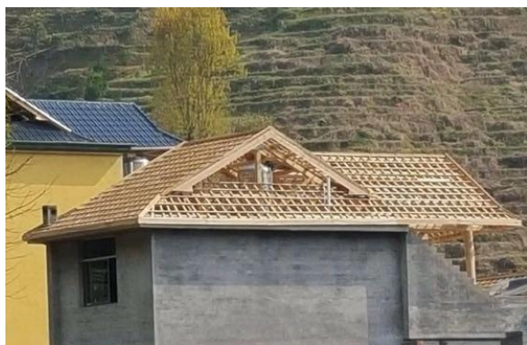
(a) 屋面水箱隐藏于坡屋面内
