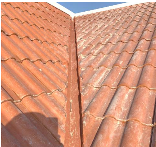
❌铁皮沟，沟与坡面水泥砂浆抹面
